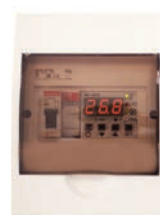
Quadro di controllo
